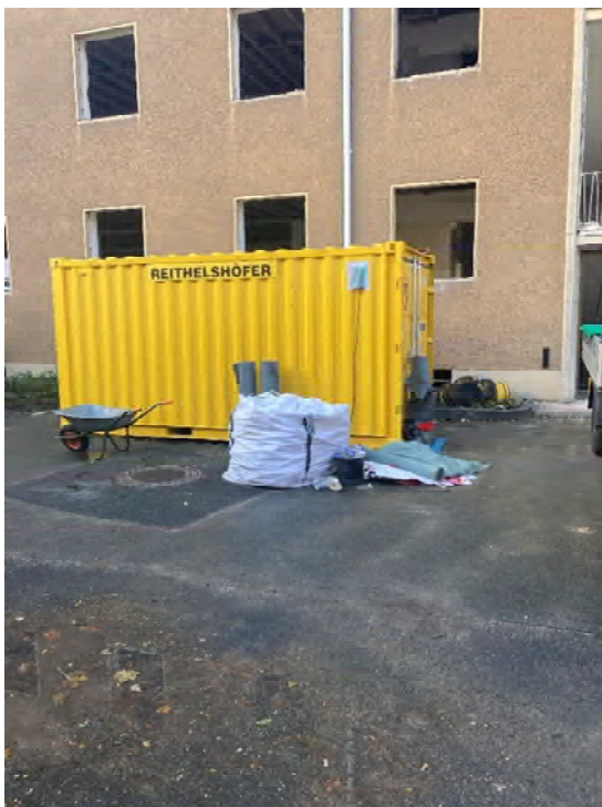
Abbildung 6: AVF 2, Schachtdeckel 15.000 I-Tank
