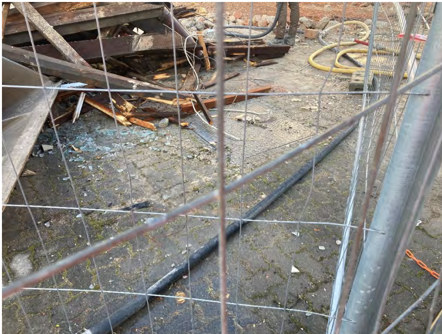
Abbildung 2: AVF 1, Schachtdeckel 10.000 I-Tank
