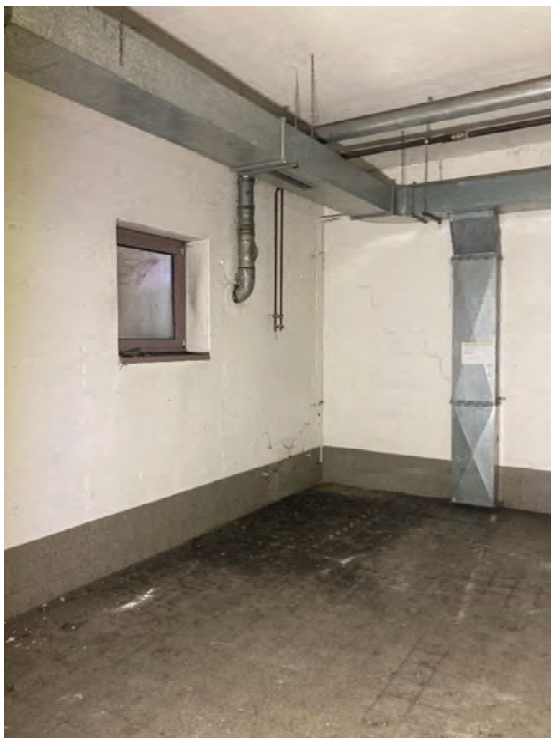
Abbildung 10: AVF 5, Lager für brennbare Flüssigkeiten
