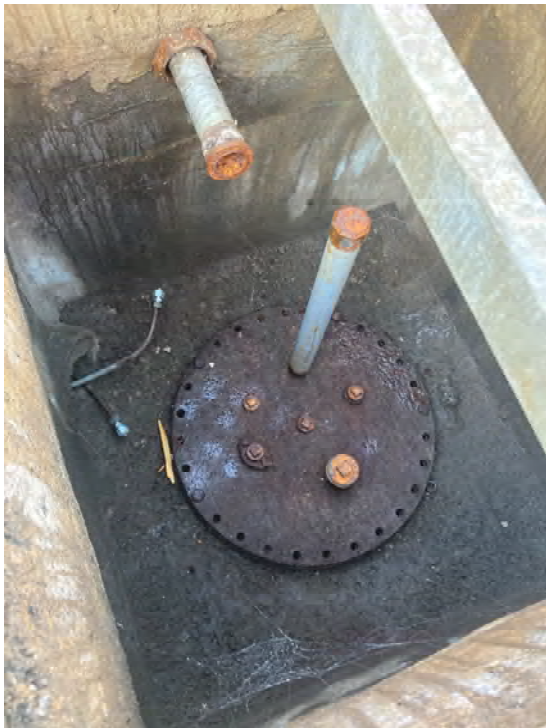
Abbildung 4: AVF 1, geöffneter Schachtdeckel 10.000 l-Tank
