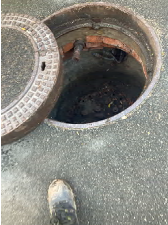
Abbildung 7: AVF 2, Schachtdeckel 15.000 I-Tank
